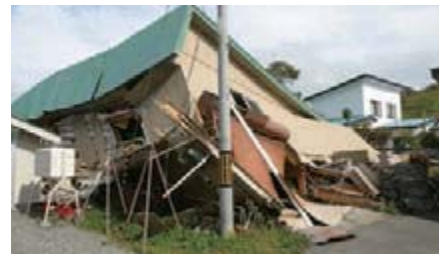
平成15(2003)年 十勝沖地震で倒壊した家屋 提供:浦河町
