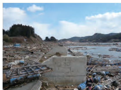
平成23年(2011年)3月 陸前高田市津波で破壊された防潮堤
